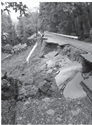
台風19号による道路崩壊現場
